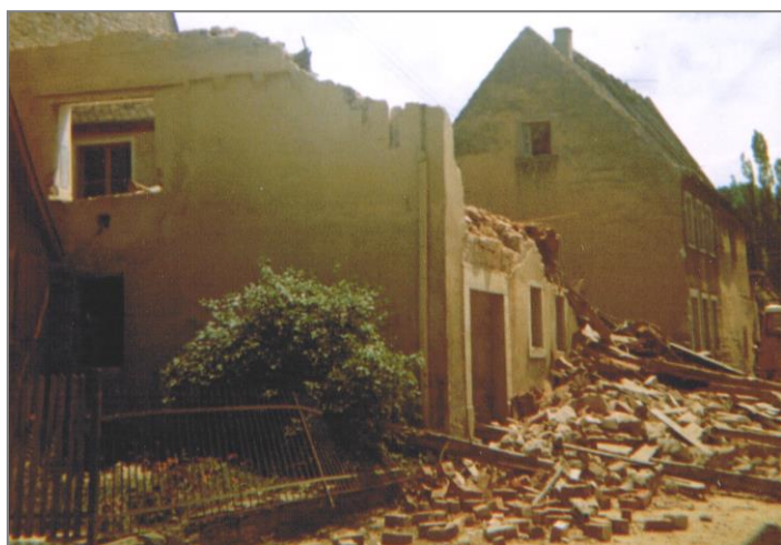
Abbruch des alten Pfarrhauses im Jahr 1972. Im Hintergrund das Schul- und Lehrerwohnhaus aus dem Jahr 1565, das zur gleichen Zeit dem örtlichen Durchgangsverkehr weichen musste.
