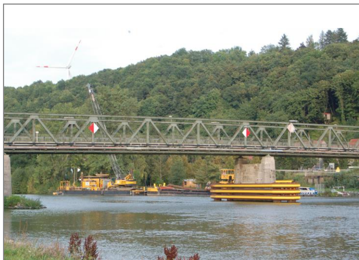
Ein Stahlkorsett, eine sogenannte Dalbe, diente als Rammschutz für den Flusspfeiler der Mainbrücke.
