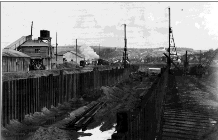
23. November 1951: Große Kammer der Spundwandschleuse vom Unterhaupt nach Oberstrom. Links die Betonfabrik.
